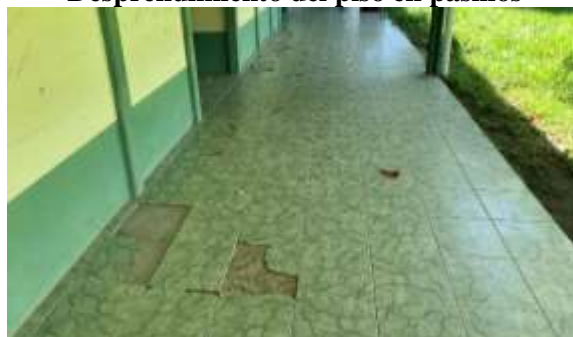
Desprendimiento del piso en pasillos
