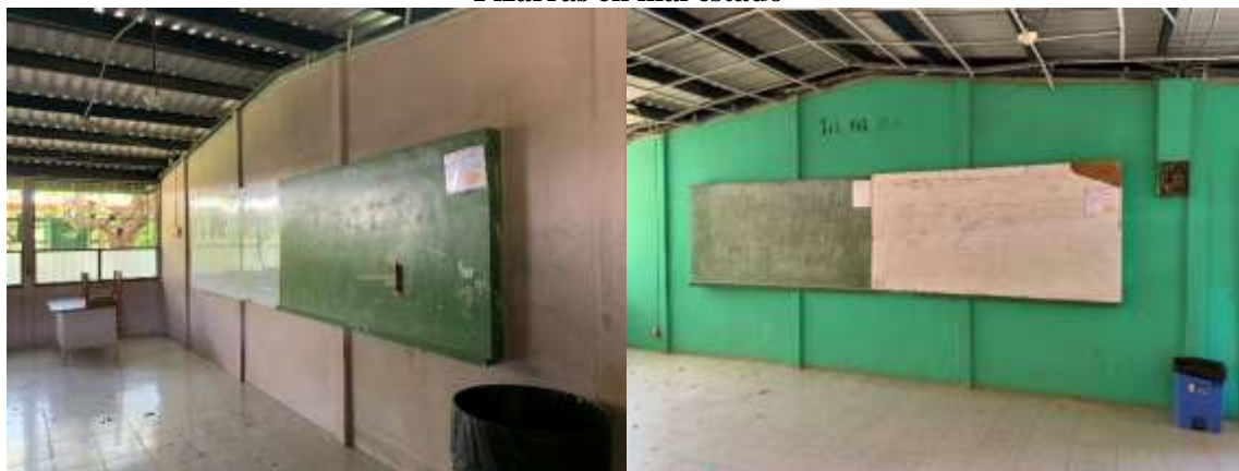
Pizarras en mal estado
