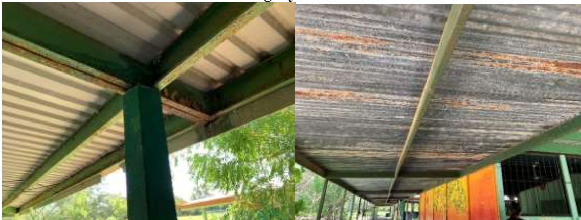
Ausencia de cielorraso en las aulas
