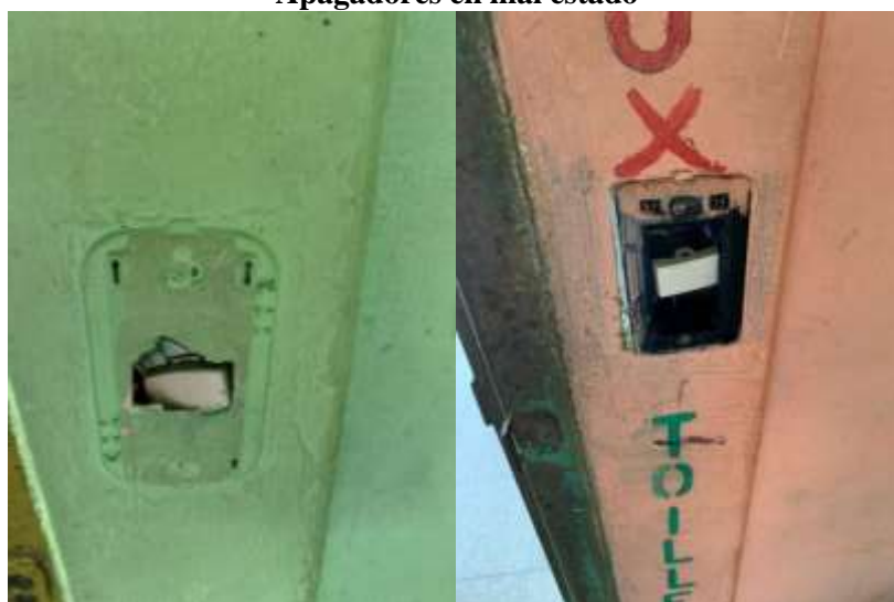
Apagadores en mal estado
