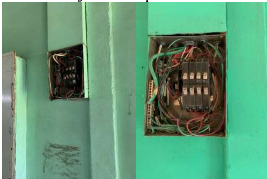
Centros de carga con cableado expuesto ubicados en las aulas
