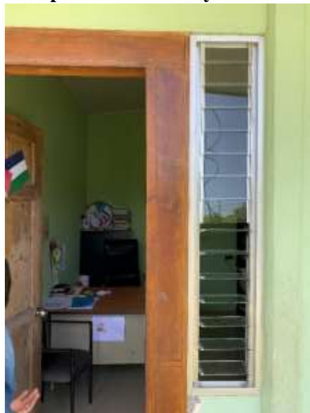
Oficinas con poca iluminación y ventilación natural
